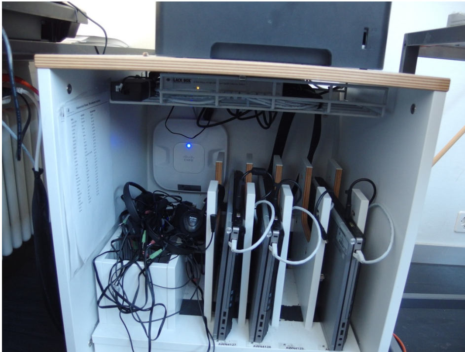
Abbildung 1: Notebook-Depotmöbel: das flache Gerät oben in der Mitte ist der Switch ("Internetverteiler"), links in der Mitte der weisse Kasten mit der blauen LED ist der WLAN-Accesspoint, senkrecht stehend drei von vier Notebooks
